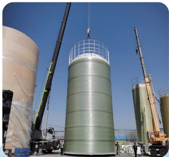
氯碱行业 废液处理
